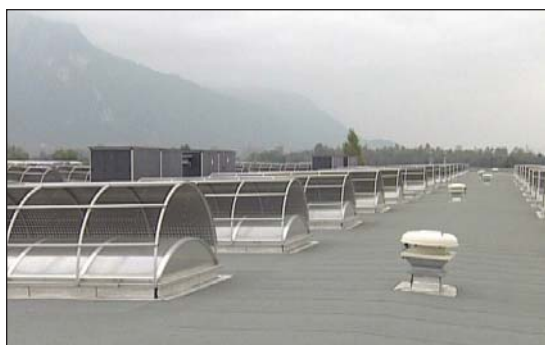
Exemple de protections solaires par l'extérieur en toiture avec groupes de rafraîchissement d'air (caissons noirs).
